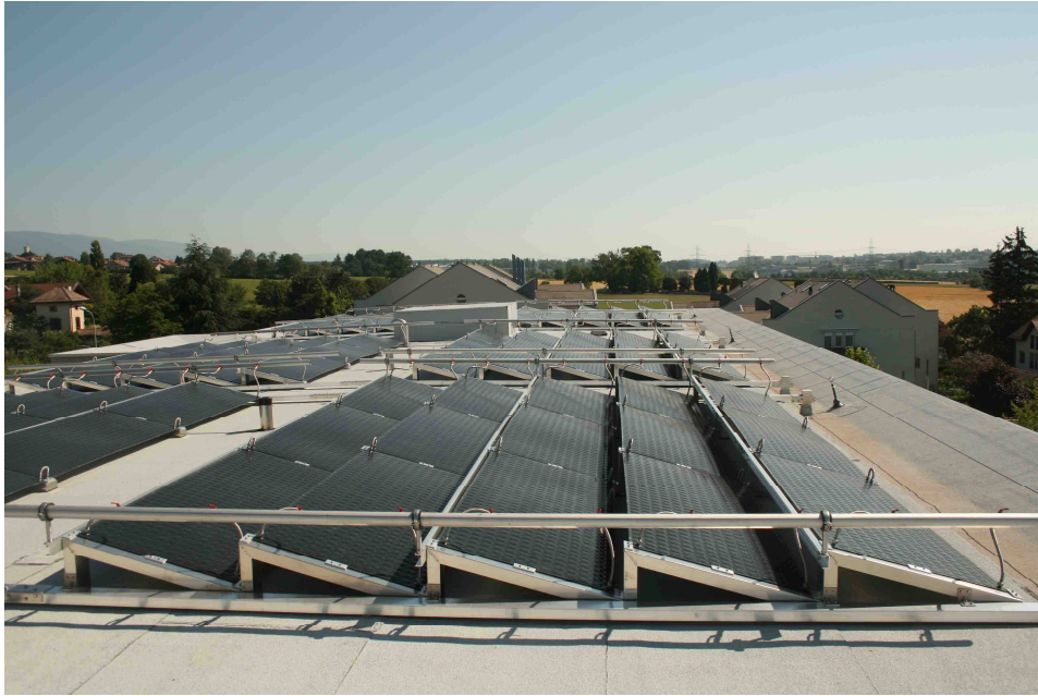
Figure 13: Capteurs solaires Energie Solaire SA installés sur le toit d'un immeuble de Solarcity
