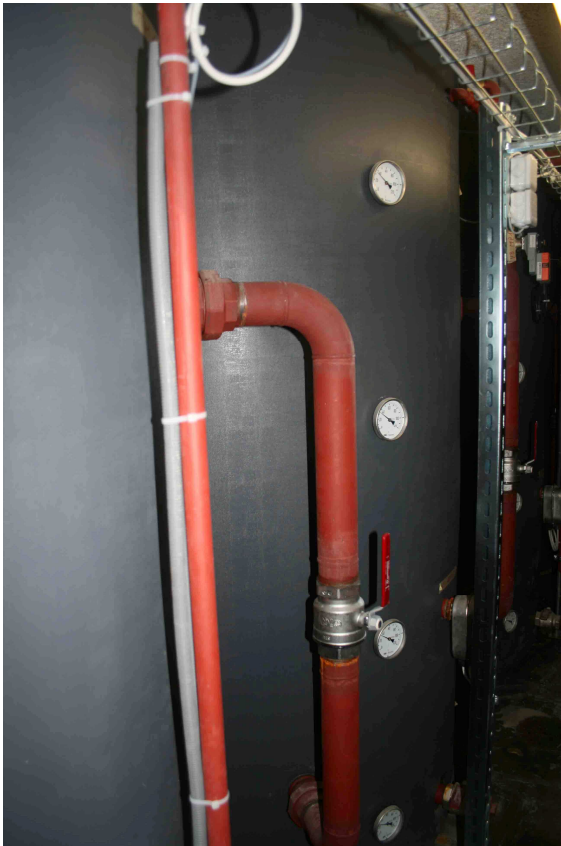
Figure 14: Ballon de stockage en chaufferie (1500 L)
